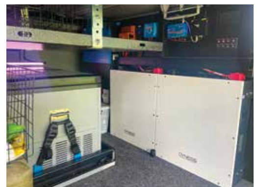
48 volt lithium batteries
